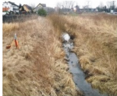
Km 4+585 Kanał ziemny nieumocniony, nieumocniony o zmiennym przekroju, z gęstą trawą i wodorostami.
