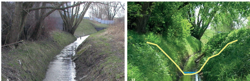
Rys. 2. Stan koryta Kanału Grabowskiego powyżej przepustu pod ulicą Poleczki: a – marzec 2008 roku, b – maj 2009 roku
