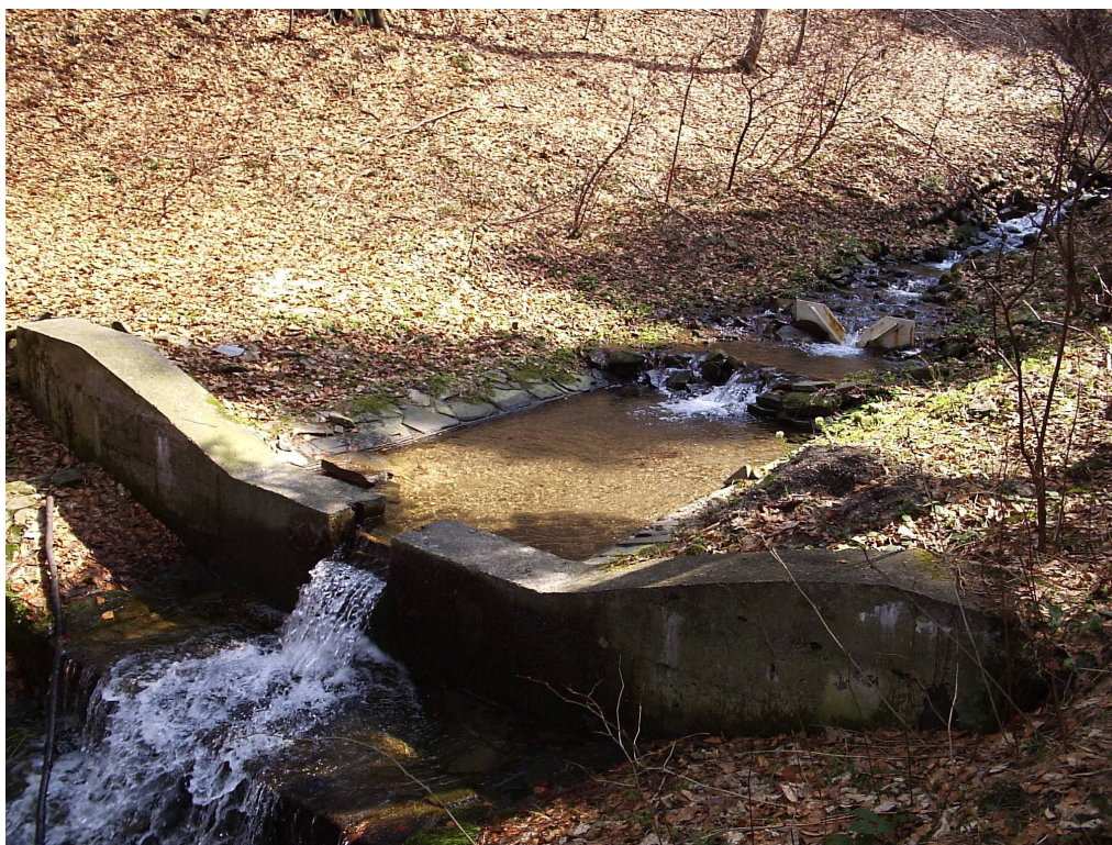
Fot. 9.4. Ujęcie infiltracyjno-poddenne na potoku Zimnym
